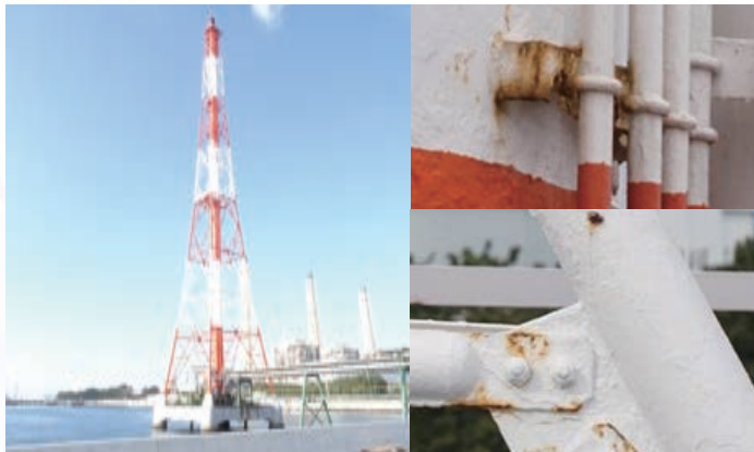
フレアスタック
